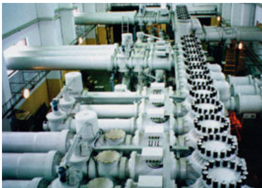
Zapouzdřená rozvodna Chodov
