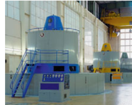
Strojovna vodní elektrárny Orlik
