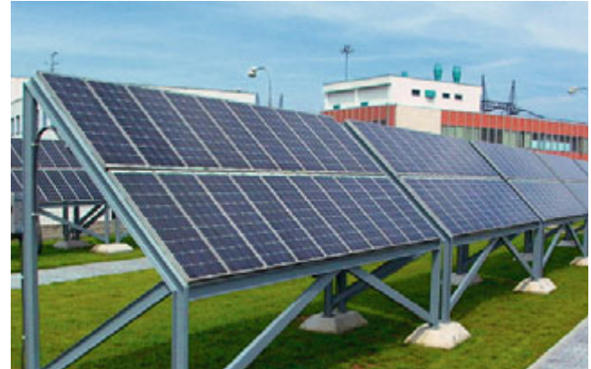
Přímé využívání sluneční energie k výrobě tepla, popř. elektřiny, je zatím stále sotva dál než v plenkách. Určitě však má budoucnost. Na snímku demonstrační fotovoltaická elektrárna v areálu Jaderné elektrárny Dukovany.
