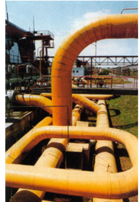
Kompresorová stanice vtačující zemní plyn do podzemního skladu
