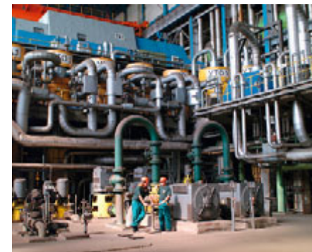
Zařízení strojovny Elektrárny Dětmarovice
