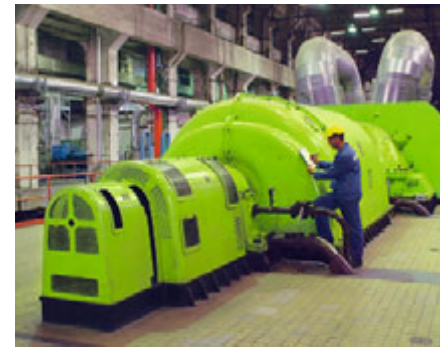
Strojovna Elektrárny Hodonín s turbínou 55 MW
