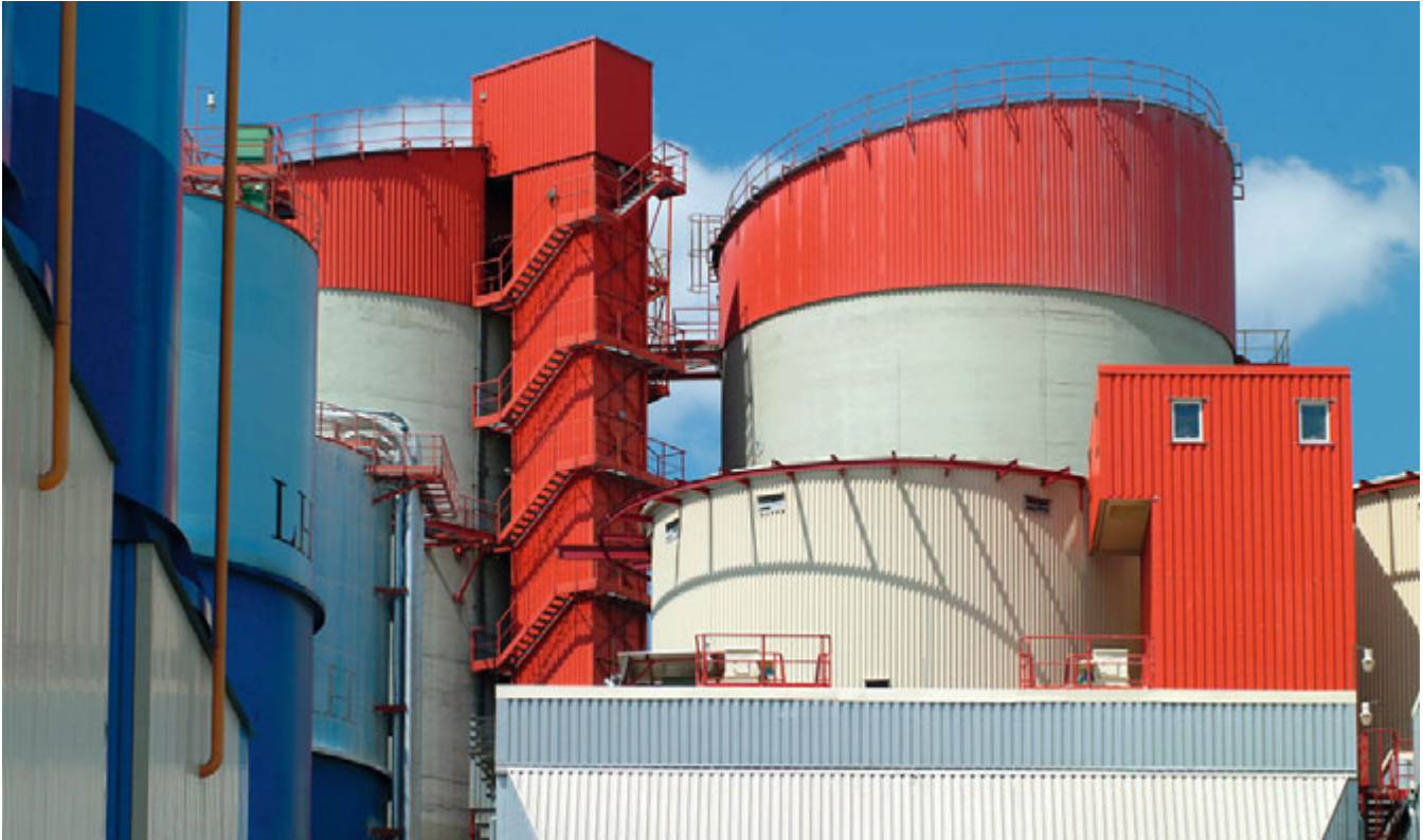
Odsiřovací zařízení v Elektrárně Ledvice
