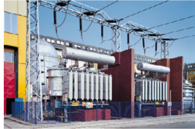
Vývod výkonu z Elektrárny Ledvice
