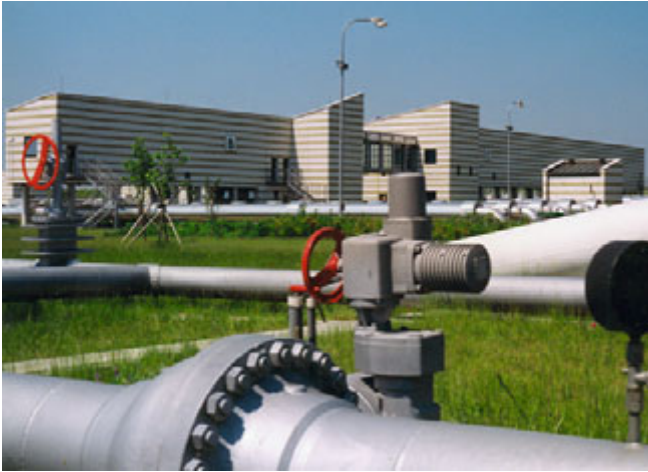
Rozvod plynu – Lanžhot (Zdroj: RWE Transgas, a. s.)
