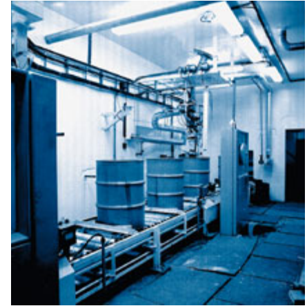
Linka na zpracování odpadů v dukovanské elektrárně
