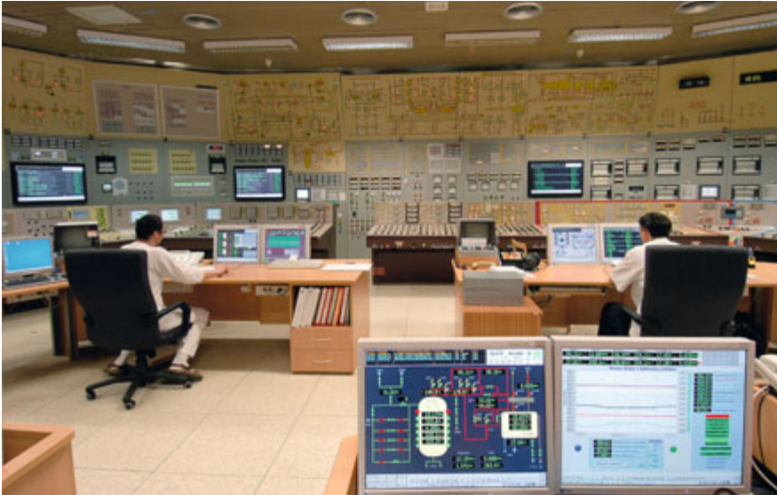
Bloková dozorna Jaderné elektrárny Dukovany
