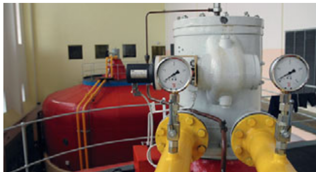
Strojovna vodní elektrárny Štěchovice
