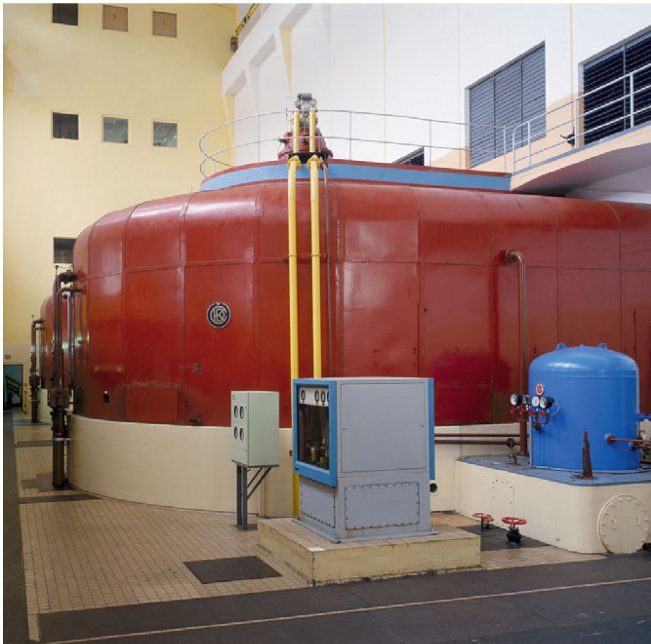
Strojovna vodní elektrárny Štěchovice
